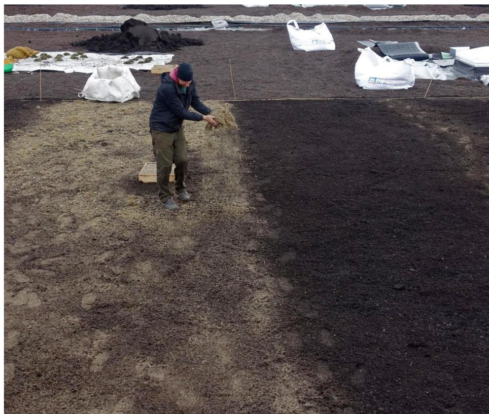
Abb. 11: Rechgut lässt sich einfach per Hand ausbringen. Um eine gleichmäßige Verteilung des Boden- und Pflanzenmaterials zu gewährleisten, kann dieses vor der Ansaat mittels Sieb (ca. 5 mm Maschenweite) in Grob- und Feinbestandteile aufgeteilt werden, die später zu gleichen Anteilen auf der Ansaatfläche ausgebracht werden.
